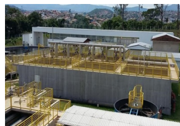
Foto 03: Reatores de Lodo Ativado
