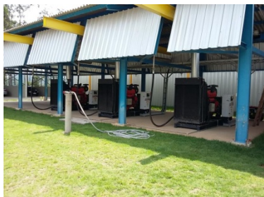
Foto 10: Sistema de Geração de Energia
