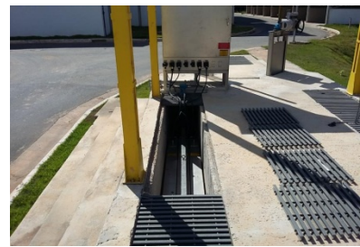
Foto 06: Sistema de Desinfecção
